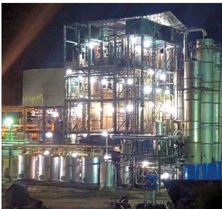
A termelétrica terá 12 mil kW de potencial instalada em Timbaúba/PE. O combustível usado para a geração de energia será o bagaço de cana
